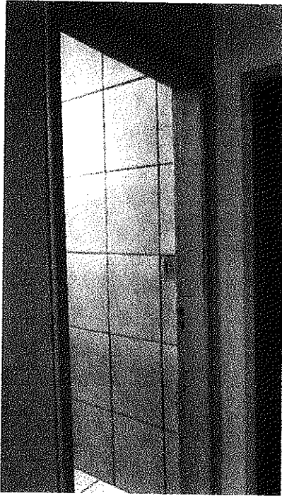
Imagem 1.: Vista da porta de acesso ao banheiro que deve passar por adequação de vão de 0,90 cm de largura e inversão de sentido de abertura, de dentro para fora.
